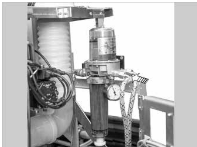
Fig. 69: Conexión de las tuberías de gasóleo
