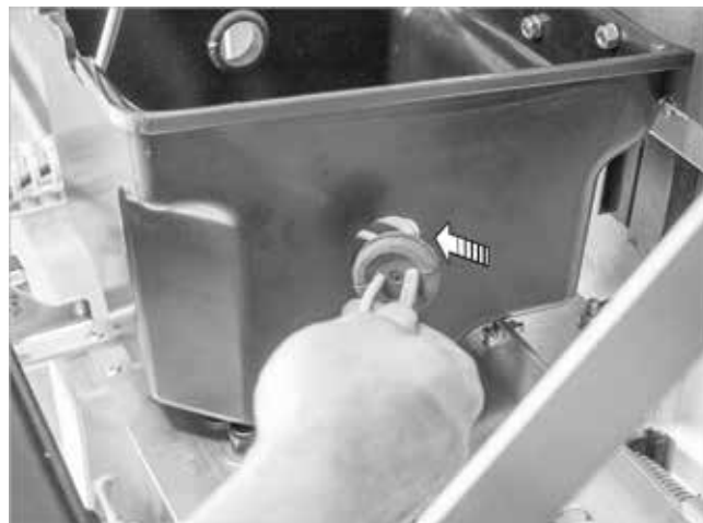
Fig. 35 : passage étanche du câble du brûleur
