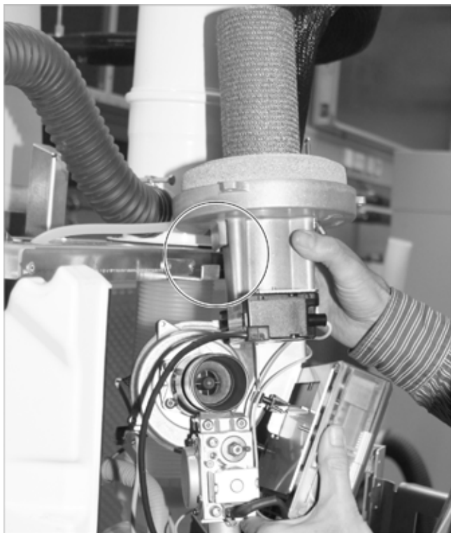
Afb. 112: Brander in onderhoudspositie aan de console
