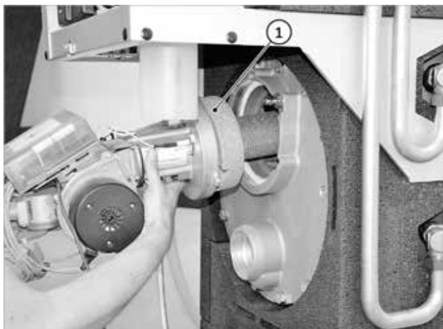
Fig. 49: Instalación del quemador
