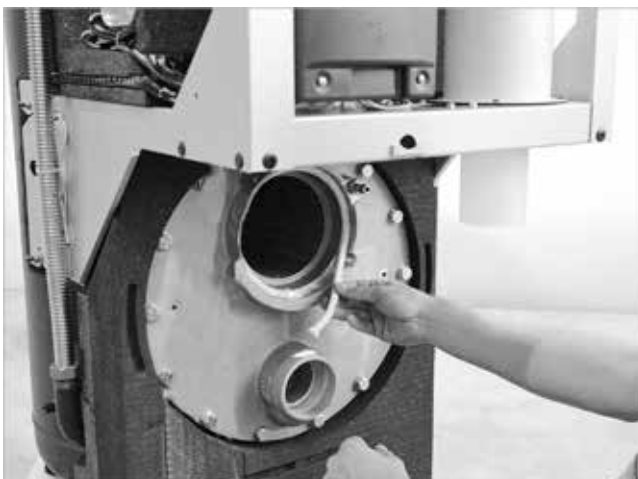
Fig. 46 : installation du cordon d'étanchéité du brûleur
