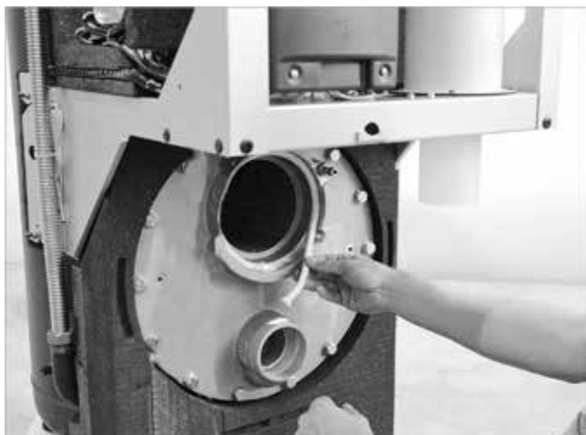
Fig. 64 : installation du cordon d'étanchéité du brûleur
