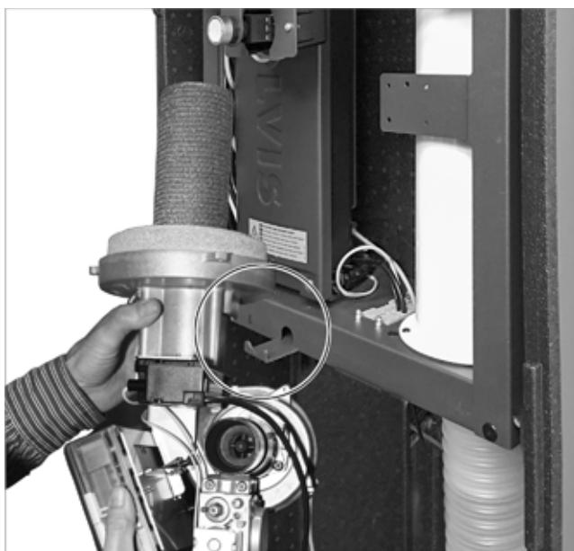
Afb. 136: Brander aan de console hangen (onderhoudspositie)
