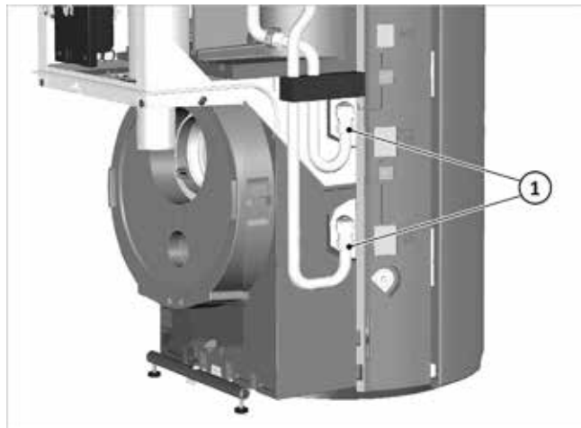
Afb. 31: De aansluitingen van de HKS controleren/vastdraaien
