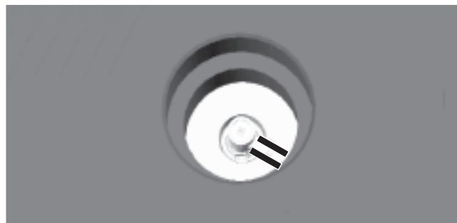
Afb. 135: Ontluchtingsslang bij ontluchter
