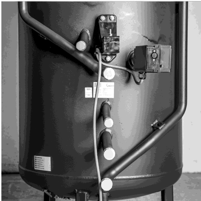
Abb. 5: Kabelführung am Heizkessel
