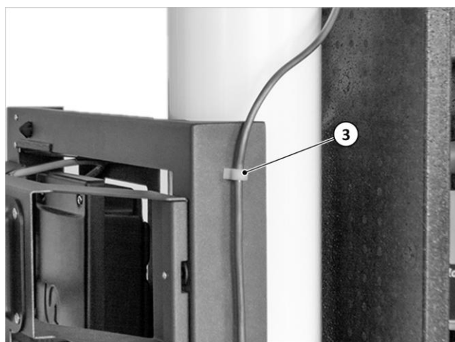
Fig. 74: Fissaggio della tubazione di alimentazione del gasolio al telaio
