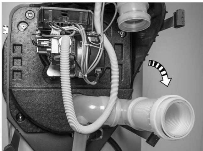
Fig. 97: Doble el tubo de escape hacia abajo.
