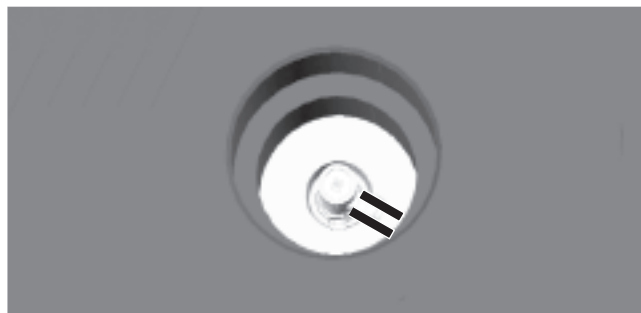
Afb. 141: Ontluchtingsslang bij ontluchter
