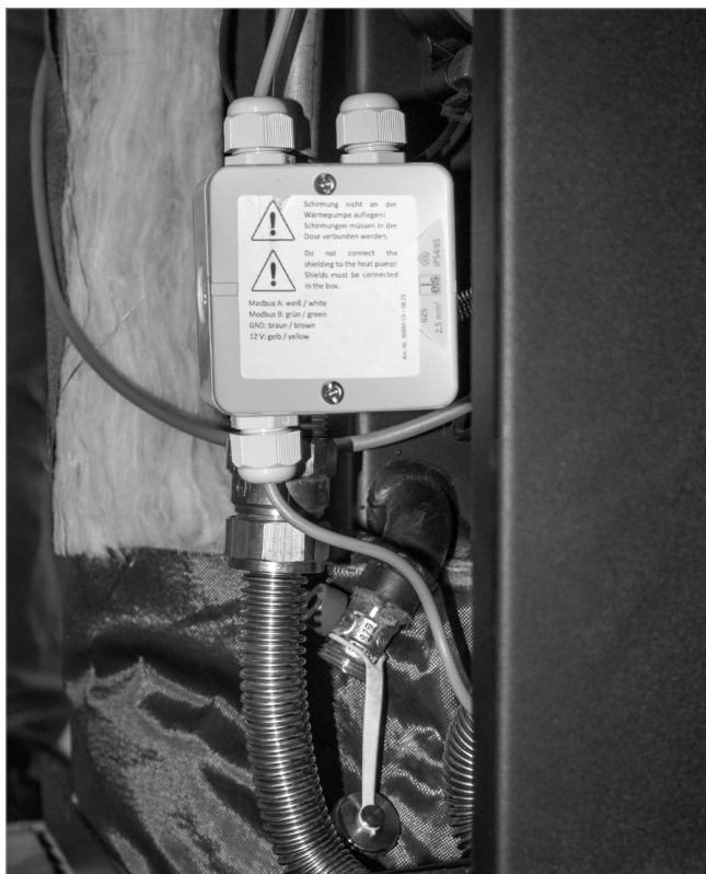
Abb. 16: Modbus Anschlussbox am Vorlaufrohr in SolvisBruno
