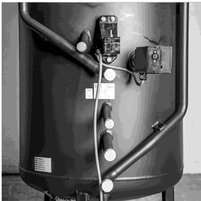
Abb. 3: Kabelführung am Heizkessel
